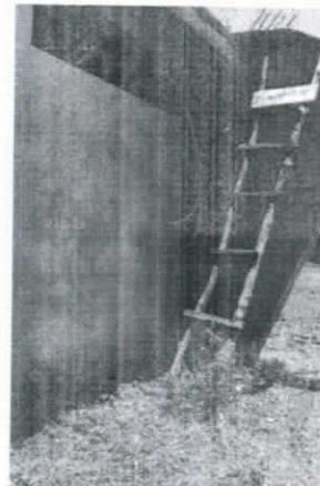
Foto 08 – Pilar "P1" não amarrado
